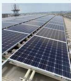
太陽光発電システム
