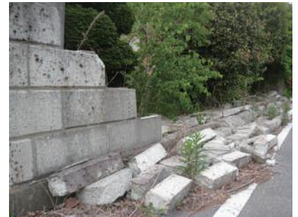
地震により石塀が倒壊
