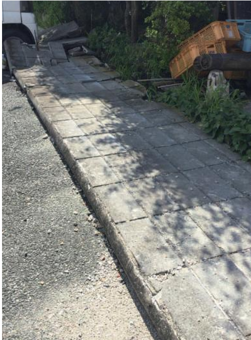
地震によりブロック塀が倒壊
