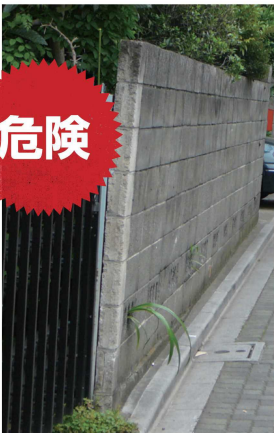
傾いている危ない塀
