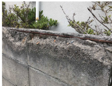
割れや鉄筋の露出がみられる塀
