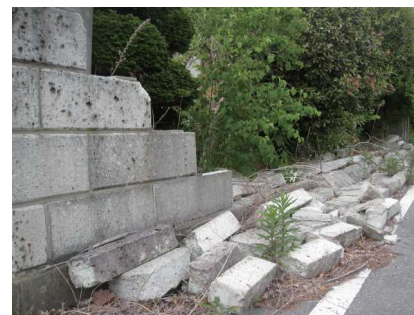
地震により石塀が倒壊
