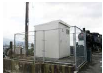
㉒ 電気設備
