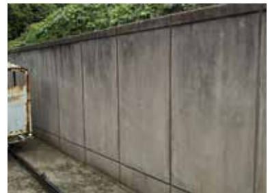
⑳ -1 コンクリート塀
